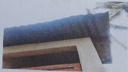
Foto 6: Se observa el deterioro de las laminas del módulo 2.
