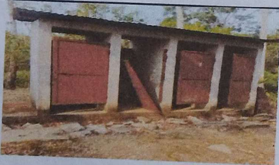
Foto 5: Se observa el deterioro de la puerta y pintura del interior y exterior de la pared del módulo 2.
