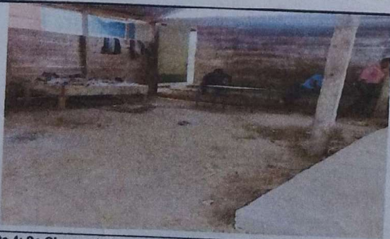
Foto 4: Se Observa la falta de piso del módulo 3.
