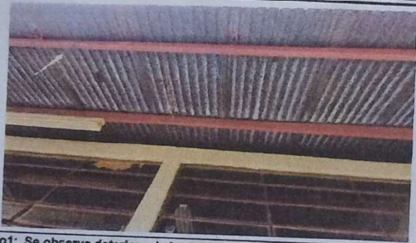
Foto1: Se observa deterioro de la pintura (costaneras)
