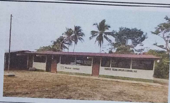
Foto 2: Se Observa deterioro del techo de laminas
